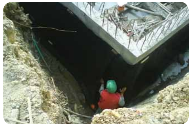
Urbanización Bosques de las Lomas, México, D.F. 2011 Geodrén Vial 100 mm / 1 mt - Geodrén Planar 2 mt
